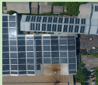
1.5 MW SRIC Solar Roof with 0.5 MWh Energy Storage, สระบุรี
