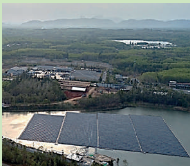
5 MW STS2 Solar Float, นครศรีธรรมราช
