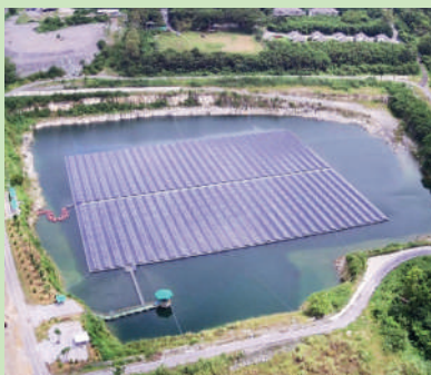
2.5 MW SKW Floating Solar, สระบุรี
