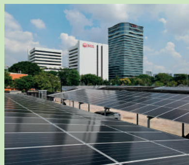
0.8 MW SCG Solar Car Park, กรุงเทพฯ
